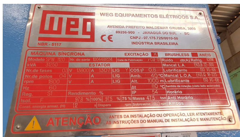
Alternator/ Generator nº 1
